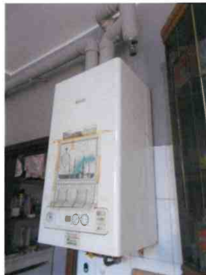
22. Caldaia (in cucina)
